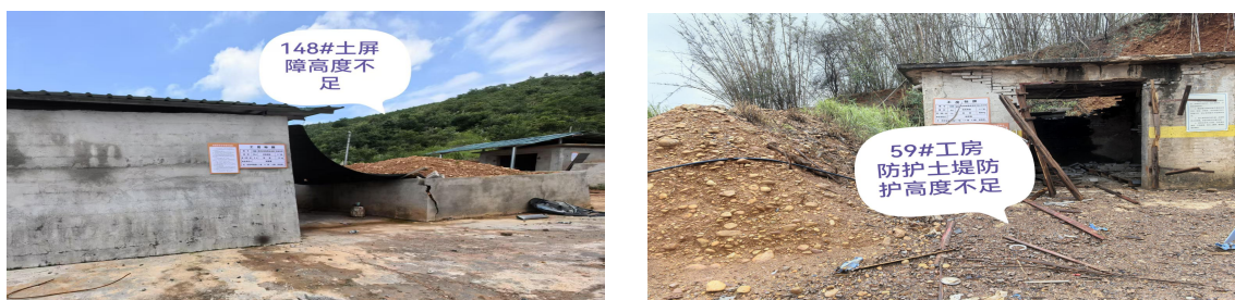
图 6 防护土堤防护高度不足
